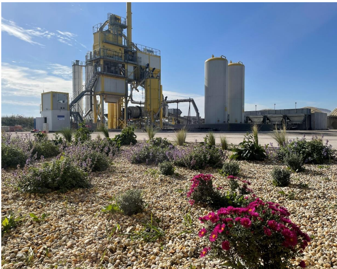
Obaľovacia súprava asfaltových zmesí
